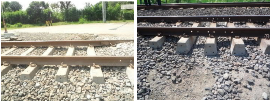
Gambar 1. 1 Penurunan dan Penggerusan Balas di Perlintasan Sebidang dan di Lintas
